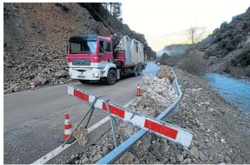
Por la mañana se limpió la calzada y se apartaron las rocas. R. GOBANTES
